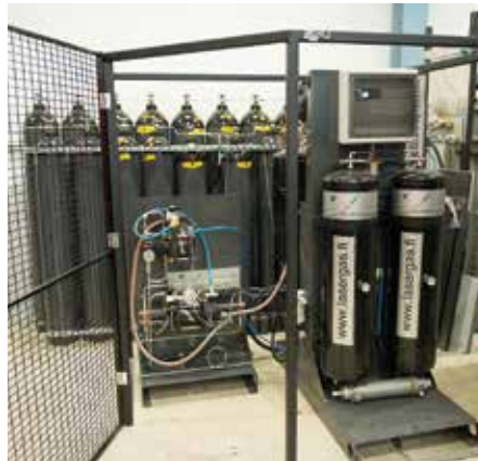
Typpigeneraattori nakuttaa lähes jatkuvasti ja erottaa ilmasta hapen ja vähäiset muut kaasut, jolloin jäljelle jää puhdasta typpeä. Pullopatteristo toimii typen puskurivarastona.
